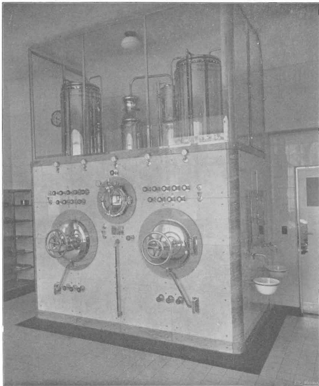
Installation de Stérilisation de l'Institut Saint Jean et Elisabeth, rue des Cendres à Bruxelles.
