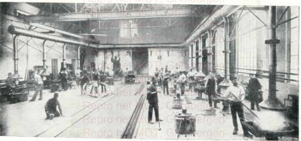
Installation de Forges Sturtevant dans une Fabrique de Machines textiles montrant les conduites aériennes d'enlèvement de fumées.
