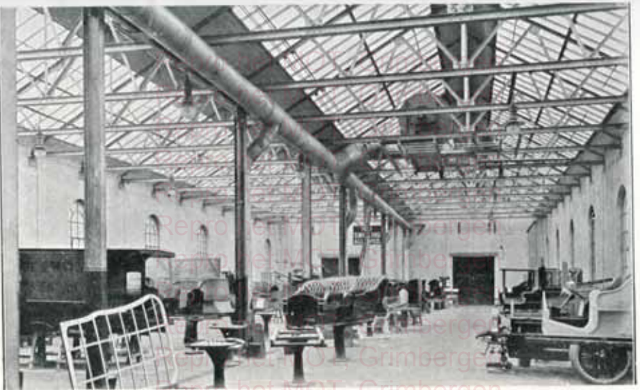
Salle de vernissage d'un atelier de construction d'automobiles, montrant le groupe calorigène et la tuyauterie distribuant l'air chaud en hiver et l'air frais en été.
