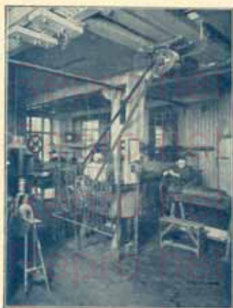
Exemple d'un moteur fixé au plafond.
