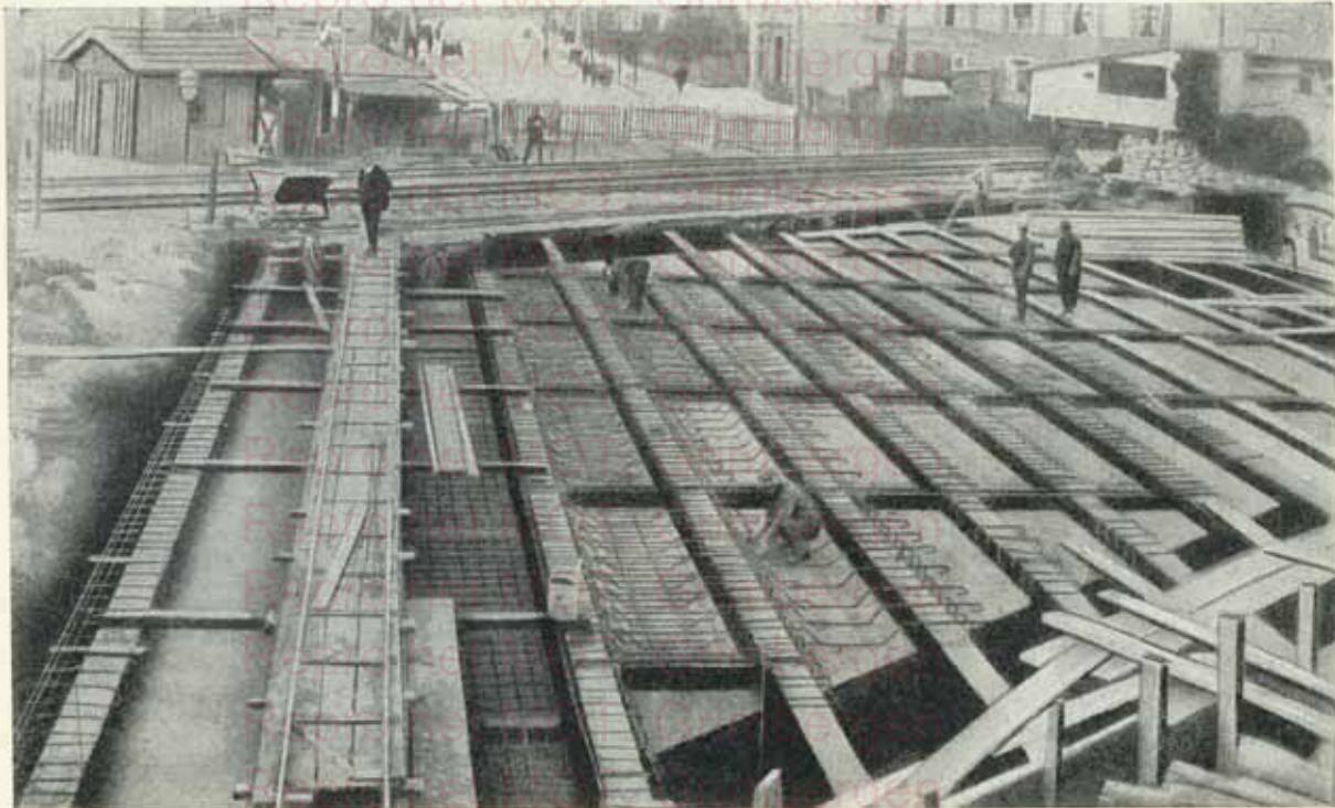
Repro het MOT, Grimbergen FIG. 9. Construction d'un passage supérieur à Zürich (Poutrelles 100 DIN enrobées) Repro het MOT, Grimbergen
