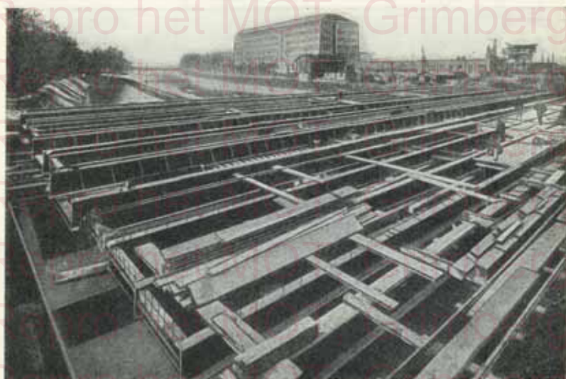
FIG. 10. — Chemins de fer fédéraux Pont en construction près de la gare de Zürich Poutrelles 100 DIN et DIR
