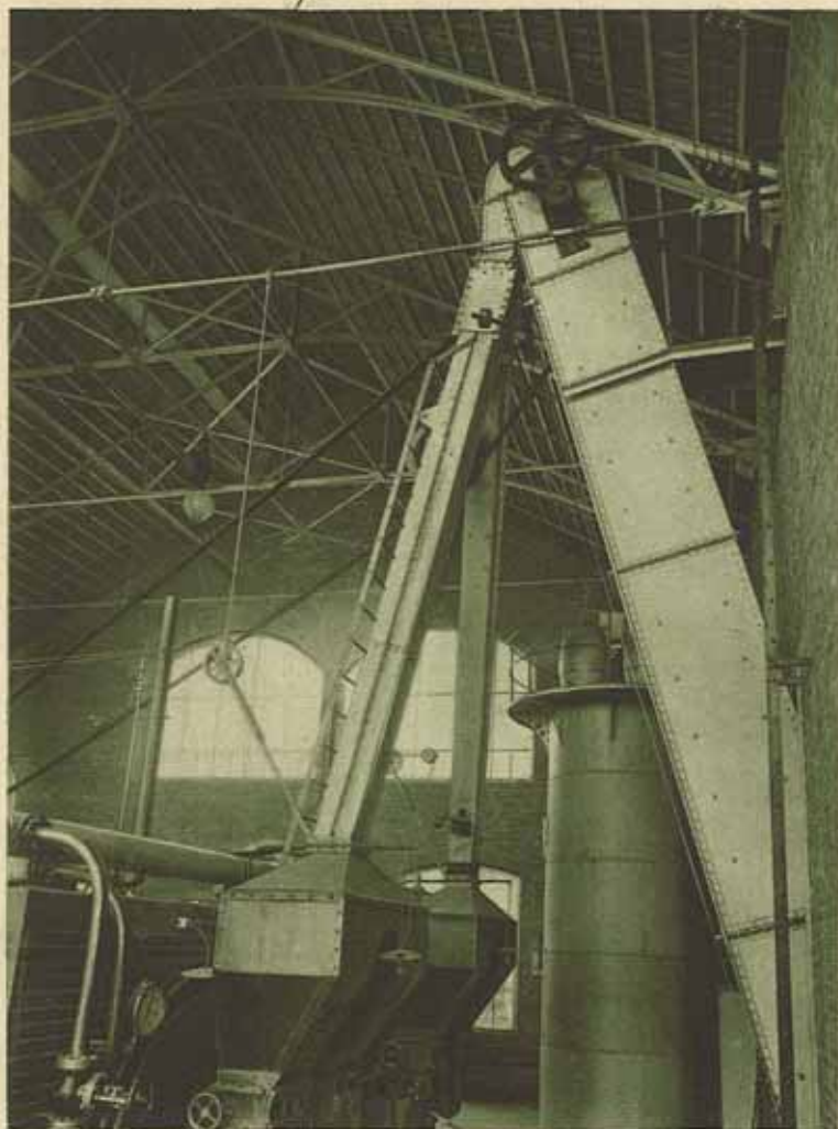
Elévateur à charbon alimentant les trémies des foyers automatiques de deux chaudières.
