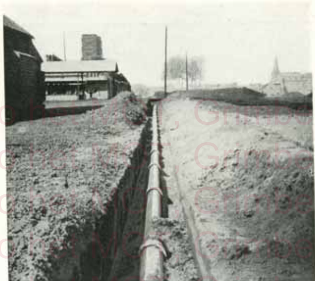
Fig. 30. — Conduite de 225 mm. de diamètre à l'Usine de Produits Chimiques de Tessenderloo.
