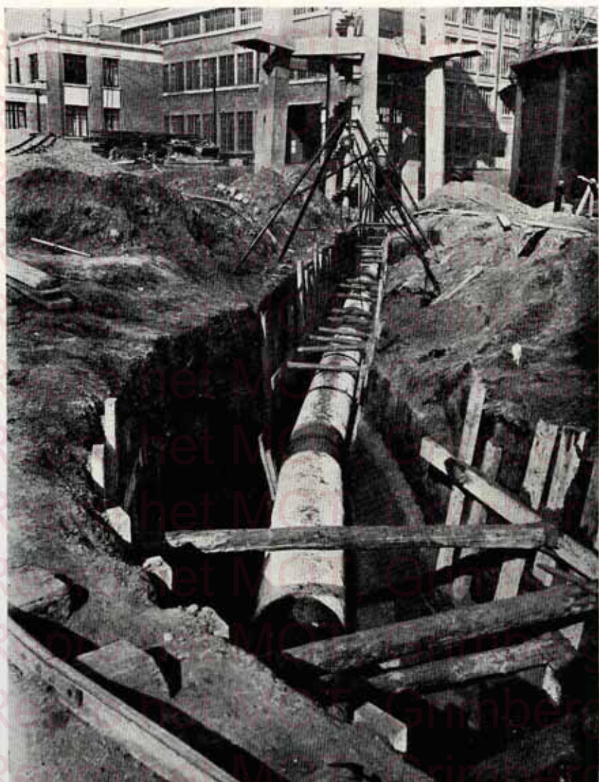
Vue d'une canalisation en tubes d'acier soudés avant remblayage de la tranchée.
