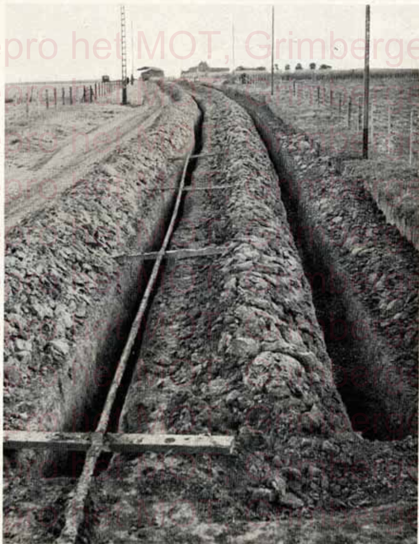
Exhumation d'une canalisation en tubes d'acier après 25 années de service.
